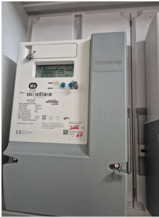
Strom: Smart Meter
